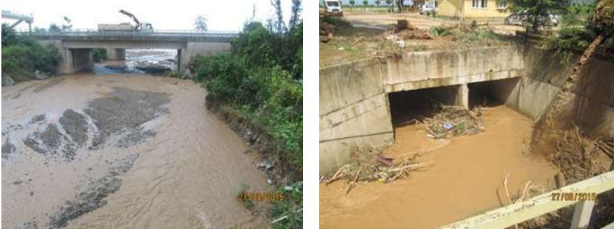
Şekil 4. Köprü ve menfezlerin tıkanması
