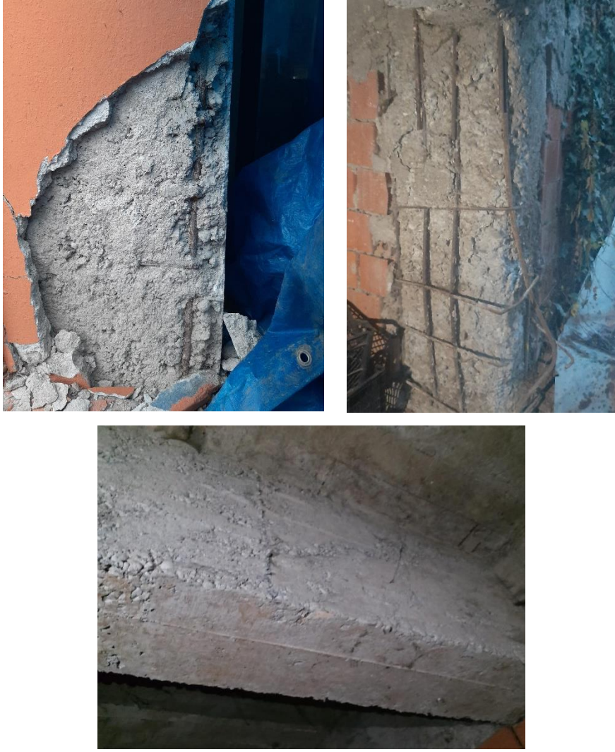
Şekil 55. 23 Kasım 2022 Gölyaka (Düzce) depreminde düşük beton kalitesinden kaynaklanan hasarlar
