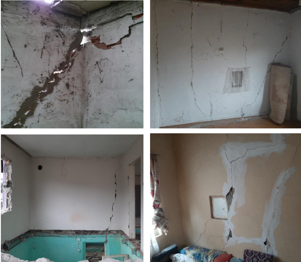
Şekil 70. 23 Kasım 2022 Gölyaka (Düzce) depreminde oluşan duvar hasarları
