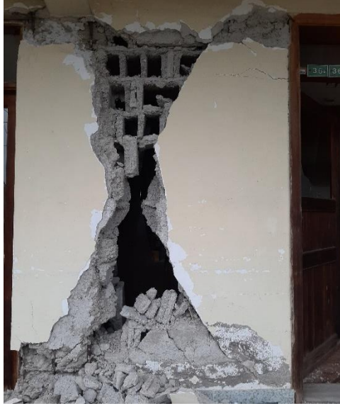
Şekil 53. 23 Kasım 2022 Gölyaka (Düzce) depreminde tespit edilen işçilik haraları
