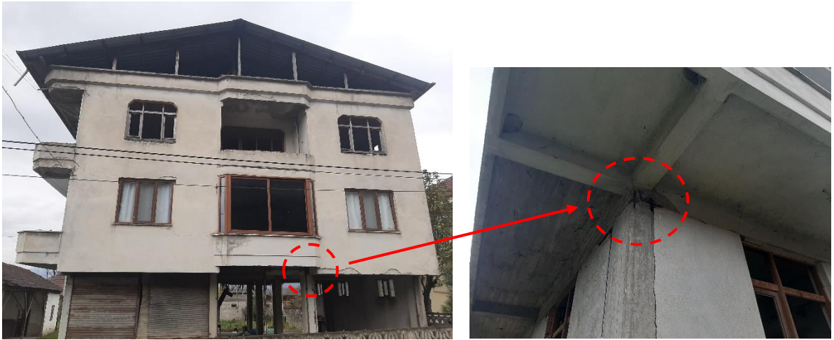
Şekil 45. 23 Kasım 2022 Gölyaka (Düzce) depreminde oluşan yumuşak kat hasarları
