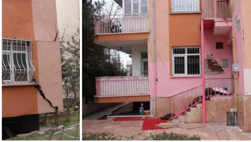
Şekil 46. 24 Ocak 2020 Sivrice (Elazığ) depreminde tespit edilen ağır çıkma hasarları [19]
