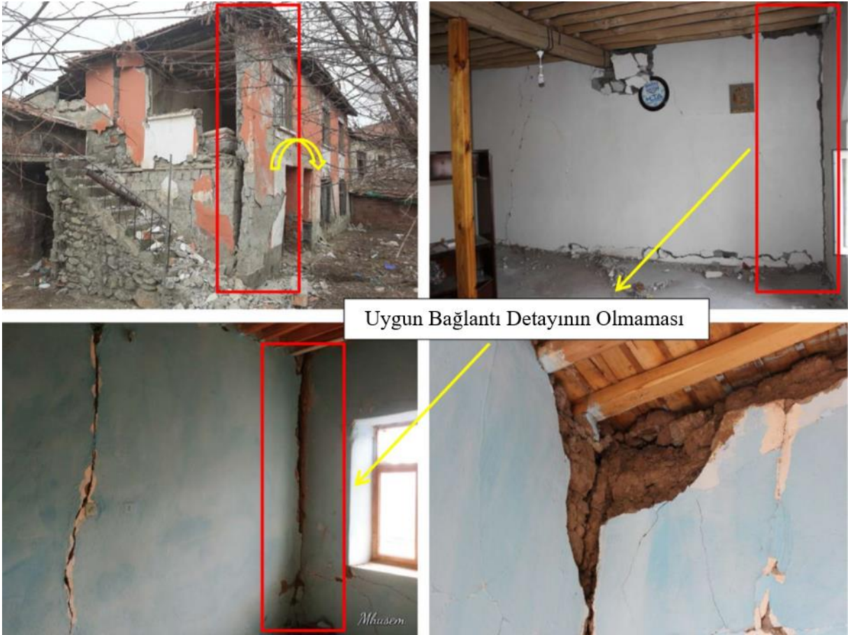
Şekil 59. 24 Ocak 2020 Sivrice (Elazığ) depreminde dikey duvarlarının birleşim bölgelerinde uygun bağlantı detayının yapılmaması nedeni ile oluşan hasarlar [26]
