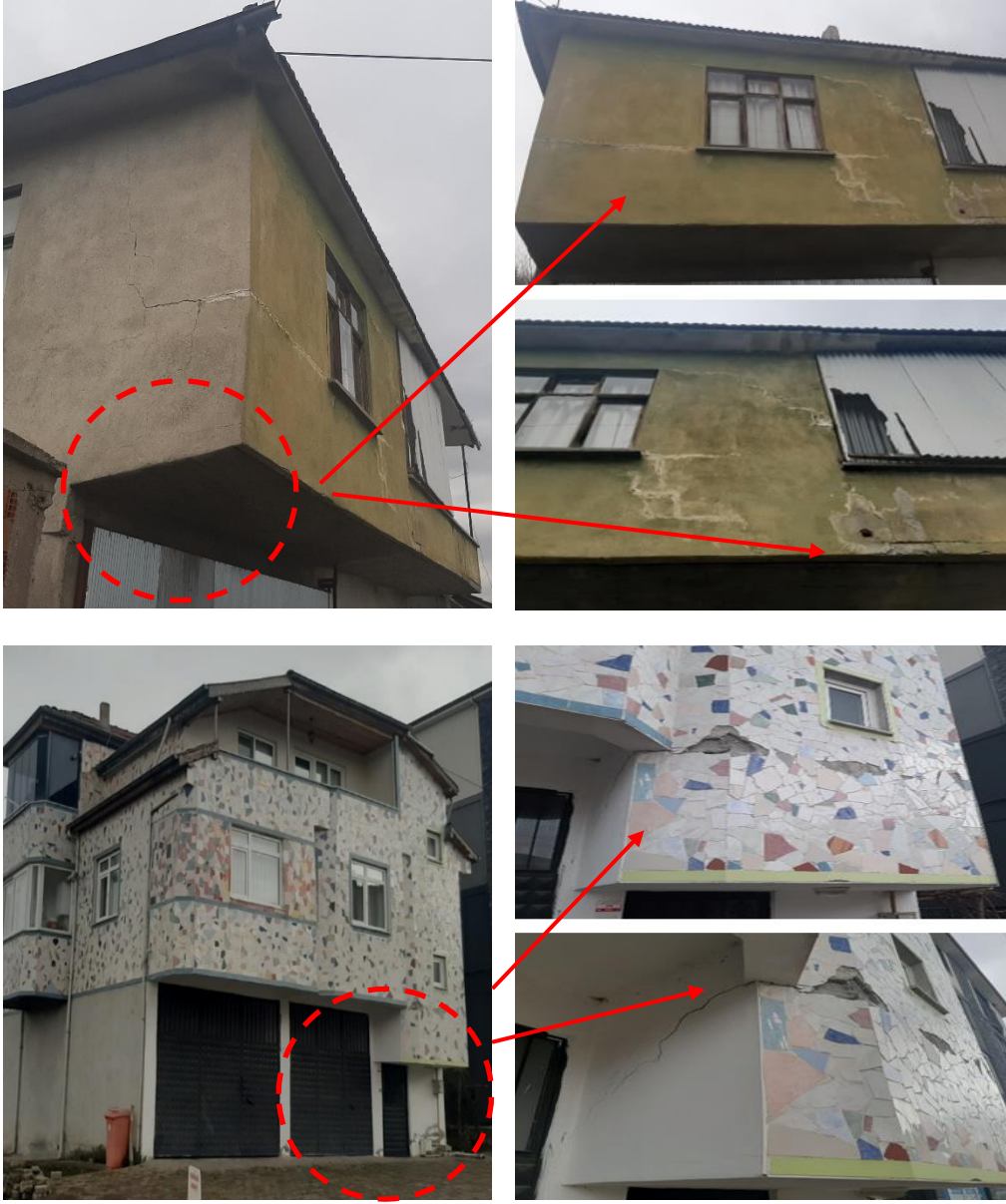
Şekil 44. 23 Kasım 2022 Gölyaka (Düzce) depreminde oluşan ağır çıkma hasarları
