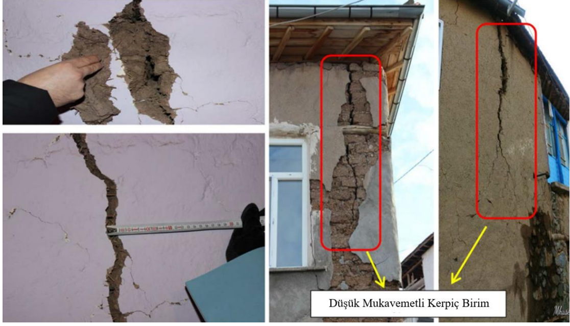
Şekil 66. 24 Ocak 2020 Sivrice (Elazığ) depreminde düşük mukavemetli kerpiç birimlerinde oluşan dikey çatlak hasarları [26]
