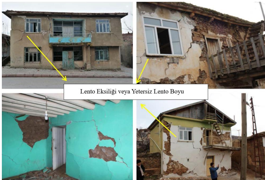
Şekil 69. 24 Ocak 2020 Sivrice (Elazığ) depreminde eksik veya yetersiz lento boyu nedeniyle oluşan hasarlar [26]
