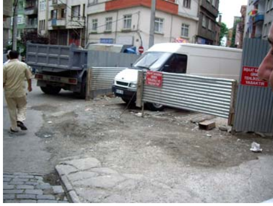
Şekil 210. İnşaat faaliyetleri sırasında kaldırımların tahrip edilmesi ve kapatılması
