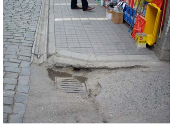
Şekil 119. Ölçüleri ve yüzey dokusu kullanılama uygun olmayan kaldırım rampaları 2
