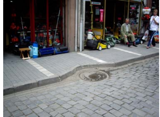
Şekil 150. Alt yapı unsurlarının kaldırım kullanım alanının daraltması 2
