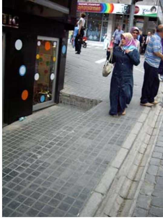
Şekil 108. Kaldırımda tehlike yaratan seviye farklılıkları 3
