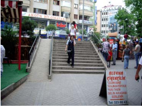
Şekil 124. Ölçüleri ve yüzey dokusu kullanıma uygun olmayan rampa 2
