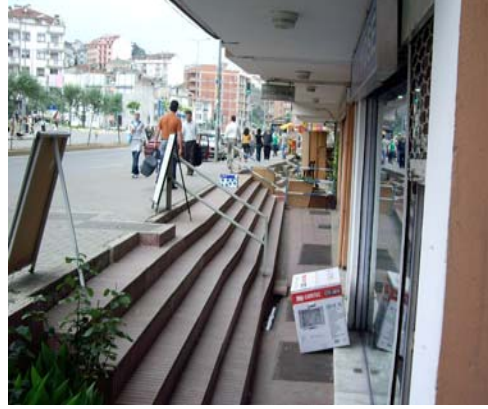
Şekil 111. Zemin seviyesinin altına inen merdivenlerin çevresinde parmaklıkların yer almaması
