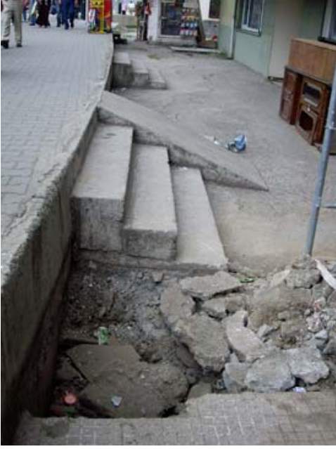
Şekil 110. Kaldırımında tehlike yaratan seviye farklılıkları 4
