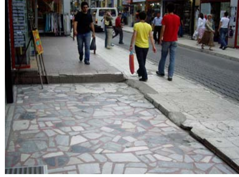
Şekil 107. Kaldırımda tehlike yaratan seviye farklılıkları 2
