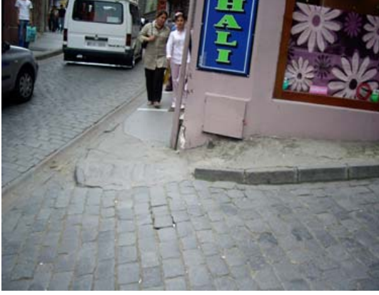
Şekil 95. Yetersiz kaldırım genişliği ve uygun olmayan kaplamalar 1
