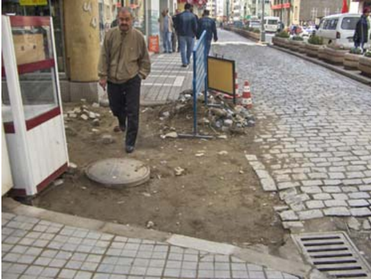
Şekil 204. Alt yapı çalışmaları sonrası onarılmamış yollar 1
