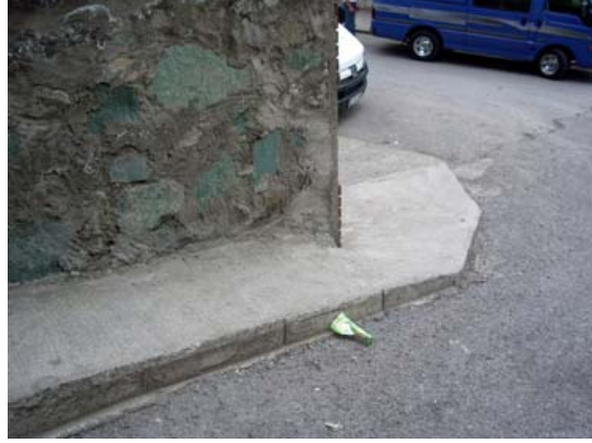
Şekil 98. Yetersiz kaldırım genişliği ve yüksek eğimli kaldırım
