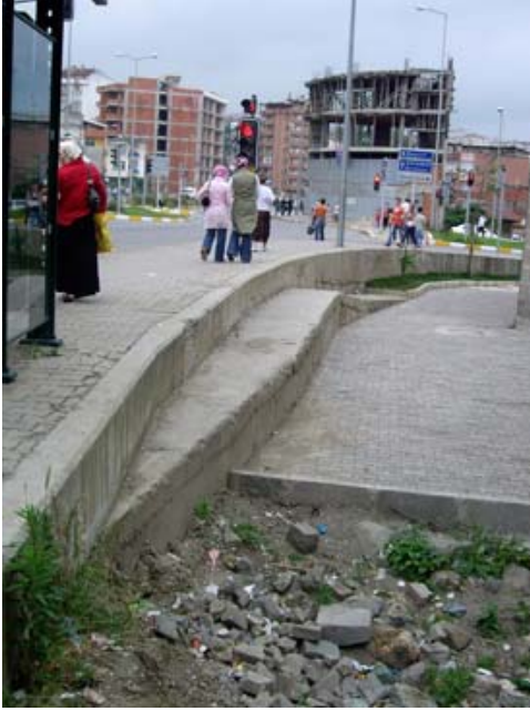
Şekil 104. Kaldırımda tehlike yaratan seviye farklılıkları
