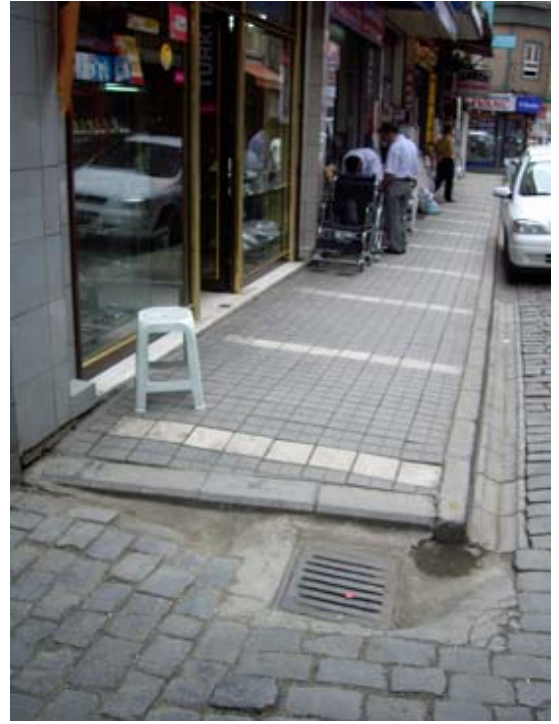
Şekil 123. Ölçüleri ve yüzey dokusu kullanılamaya uygun olmayan kaldırım rampaları 5
