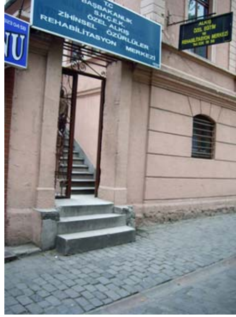
Şekil 192. Tekerlekli sandalye kullanan engelliler için uygun düzenlenmemiş rehabilitasyon merkezi girişi
