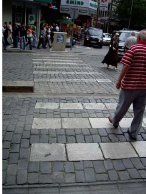
Şekil 136. Yanlış tasarlanmış iki kademeli geçiş düzenlemesi 5
